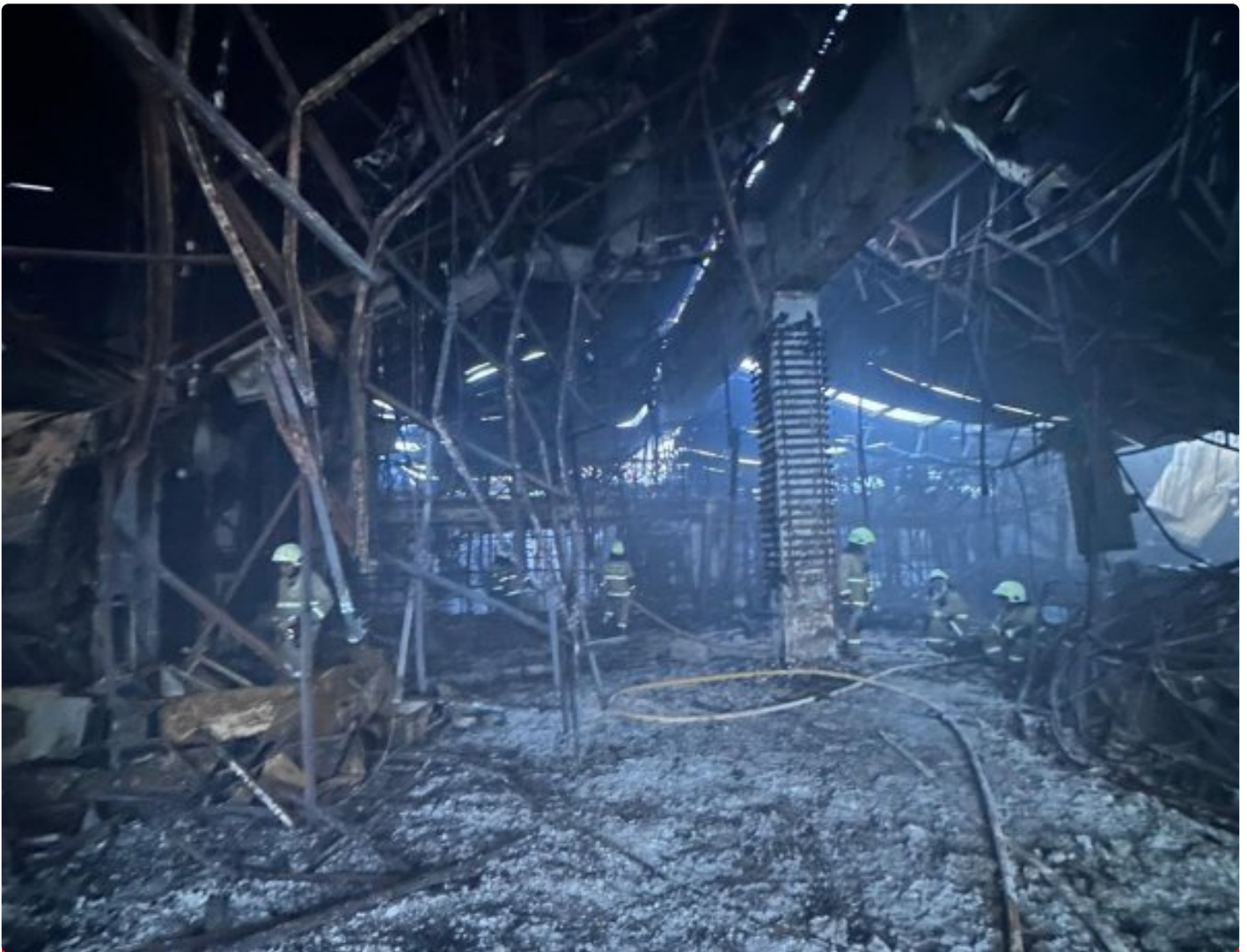
Glodok Plaza yang Hangus Terbakar
